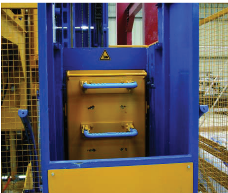
Автоматическая система транспортировки и складирования Transexact является важным элементом автоматической установки на заводе компании Bonna Sabla
